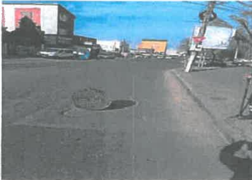
CCG2 placa la nivel asfalt si exfolieri
