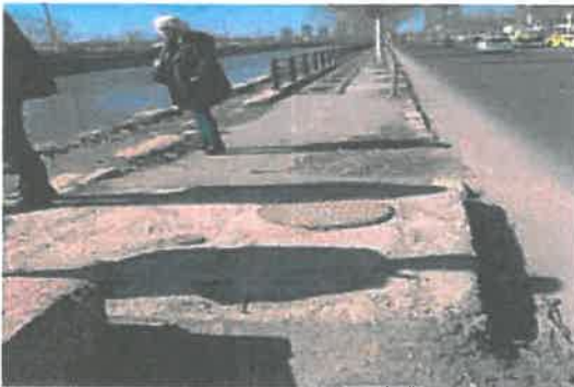
CDE placa la nivel asfalt
